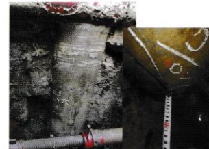
写真2:杭頭付近の損傷状態
