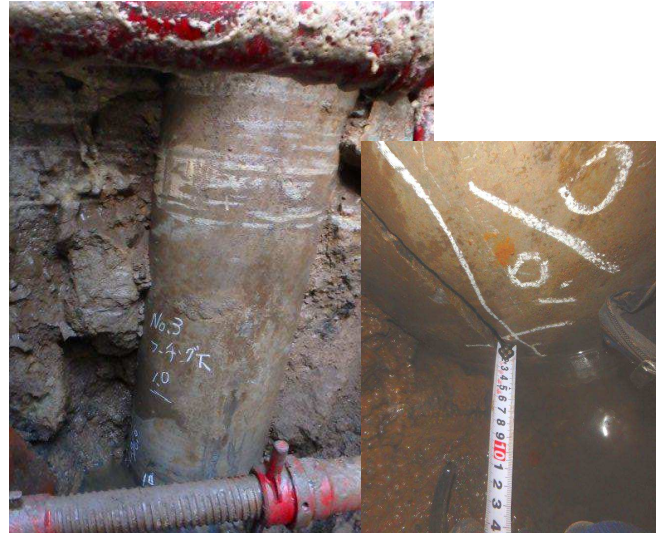
写真-1 杭頭付近の損傷状態・拡大写真
